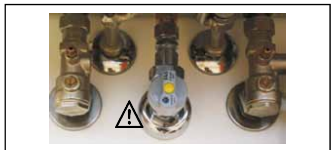
Illustration : raccordement au gaz : danger d'intoxication et d'explosion dû aux émanations de gaz
